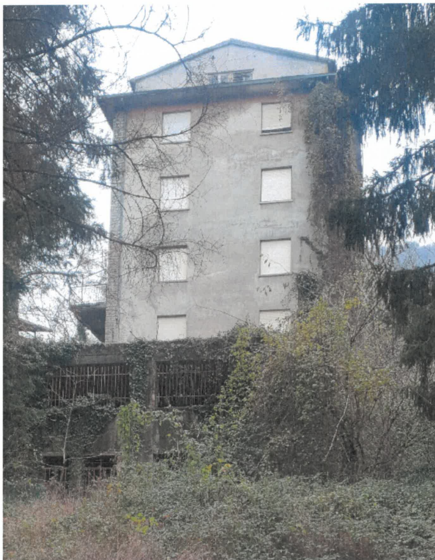
Immagine di insieme lato valle (visibili quasi tutti i livelli del complesso)
