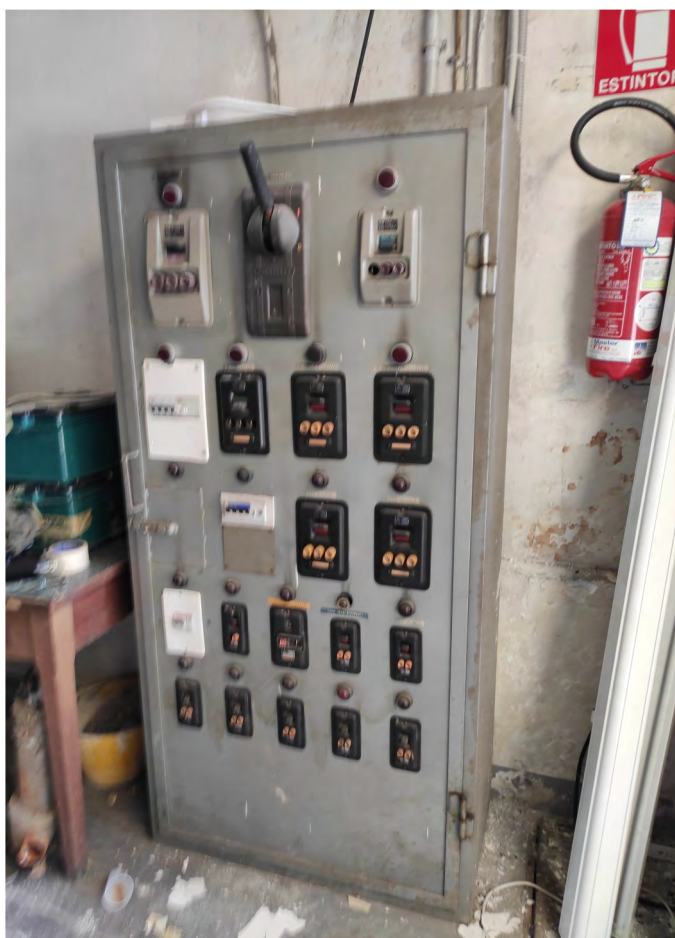
Foto F3 Tipologia Impianto Elettrico
