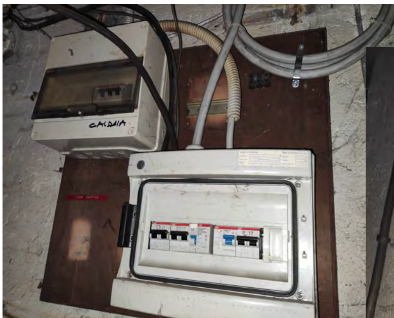
Foto F1 Tipologia Impianto Elettrico
