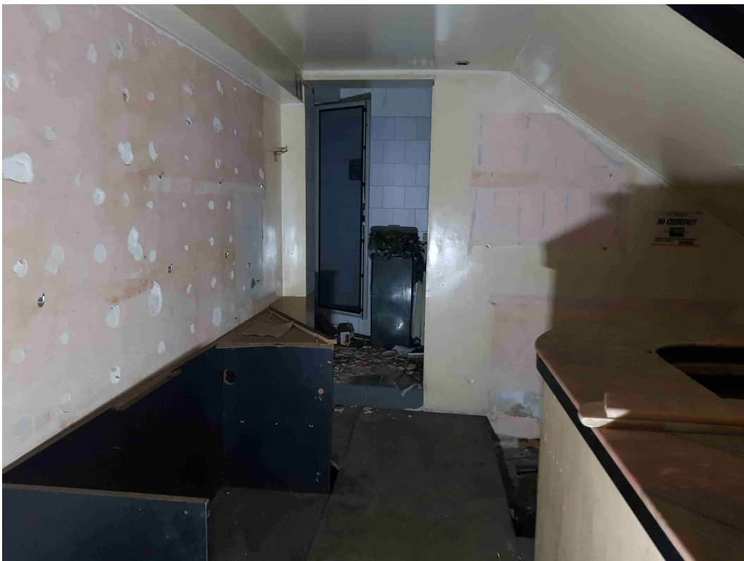
foto n.14 – particolare rampa scale ingrasso Viale Gramsci 185 - ripostiglio
